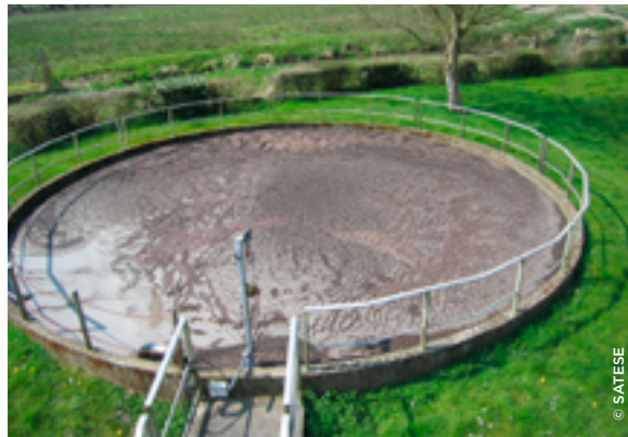
Silo de stockage - Boues liquides : Station d'épuration d'Héricourt en Caux
